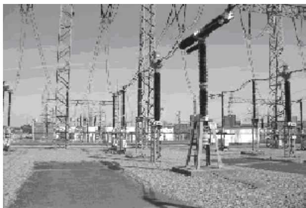
Obrázek 3: Část rozvodny Nošovice
