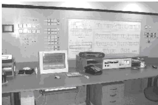
Obrázek 2: Dispečink v elektrárně
